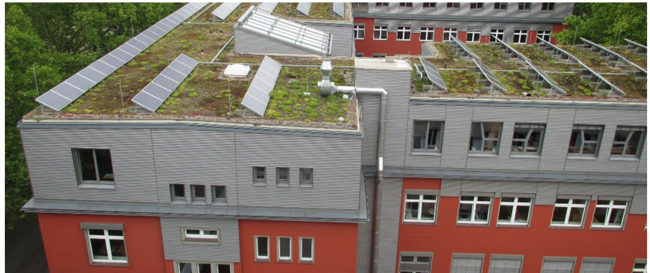
Photovoltaikanlagen auf den Dachflächen einer kommunalen Liegenschaft
